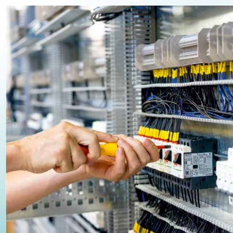
VÝROBA ELEKTRICKÝCH ROZVADĚČŮ
